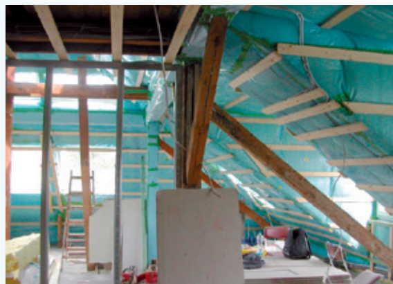
Vazдушna barijera je još uvek vidljiva: Ovo je optimalni trenutak za BlowerDoor merenje.
